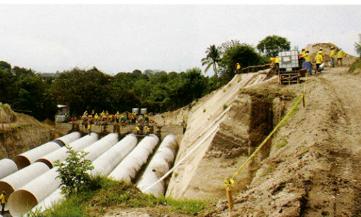
Tuberías de gran diámetro para minimizar la fuerza de las aguas lluvias hacia comunidades abajo de la San Felipe II
